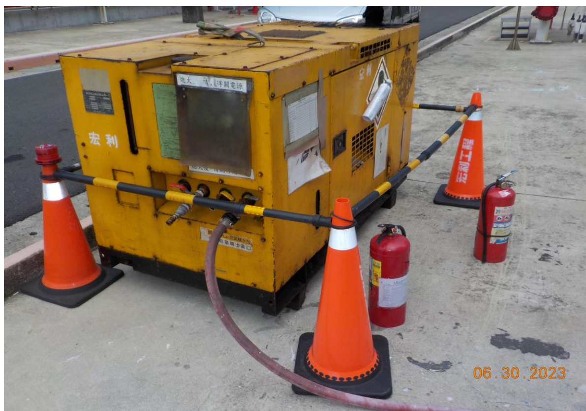
4. 空壓機定位(含滅火器)情形
