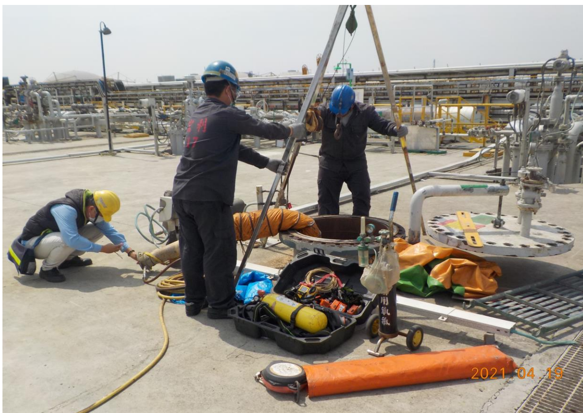
4. 槽外三腳架及通風情形
