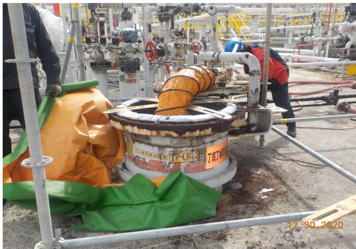
5.通風設備定位情形
