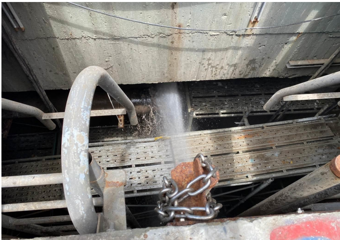
4. 接收端管內排壓情形
