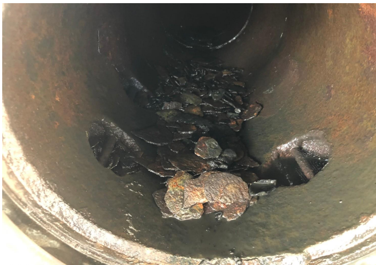
7. 接收端收料管內情形
