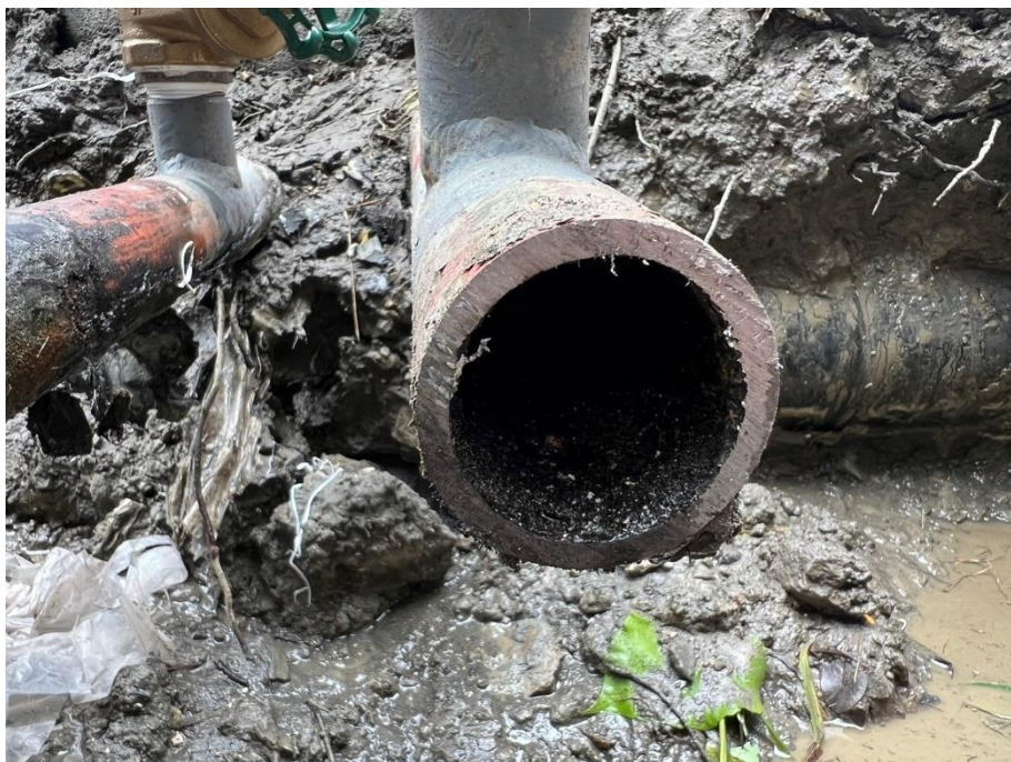
23. 管線切管後內部情形(阻斷率 99%)
