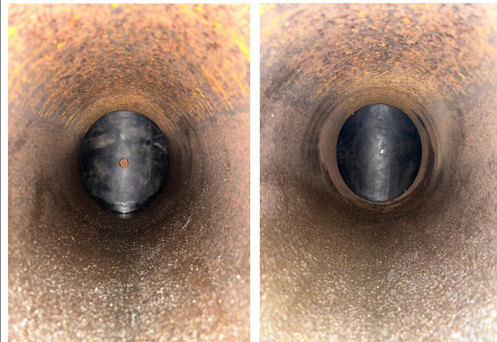
16. 管線阻斷後管路內部阻斷情形，阻斷率 99%
