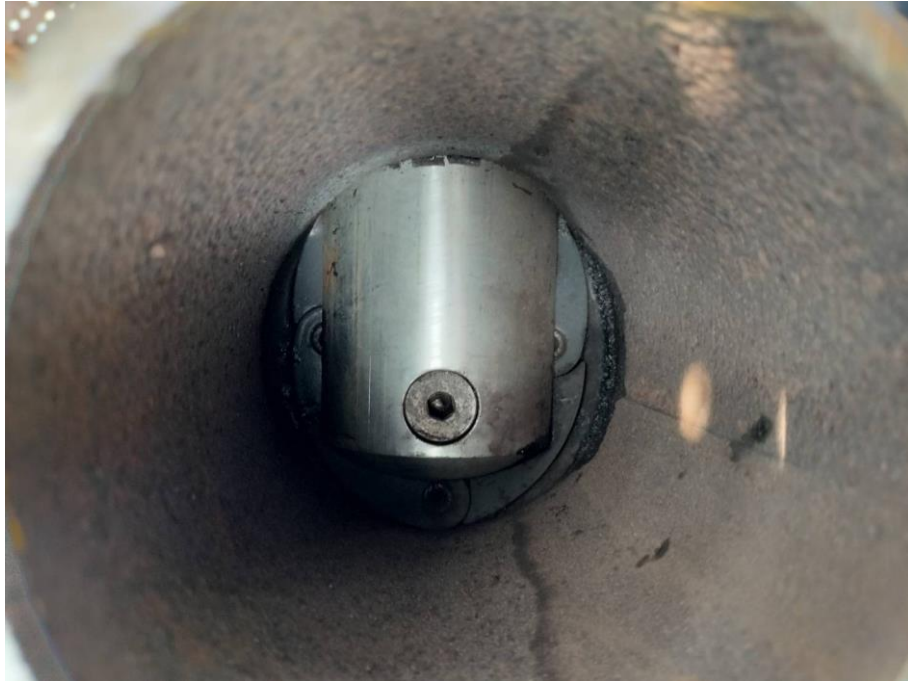
15. 管線切管後管內阻斷情形，阻斷率 99%
