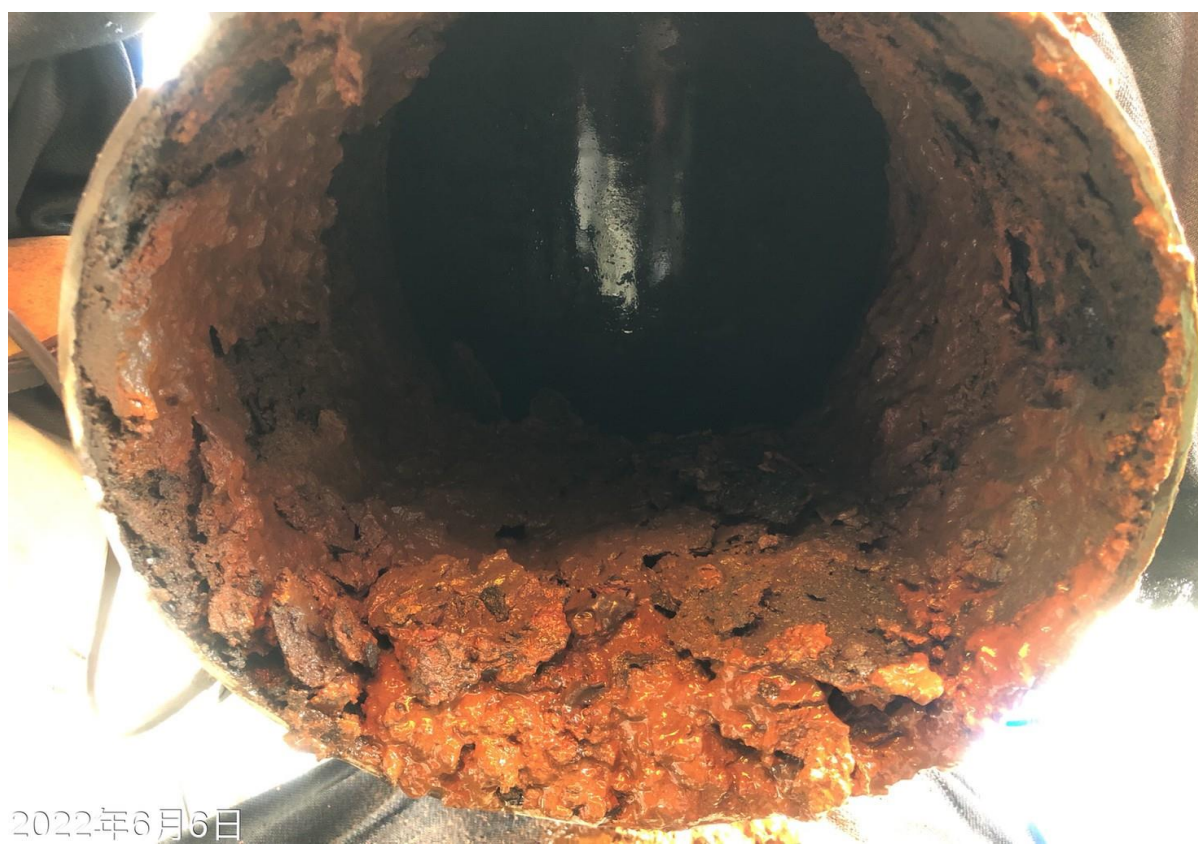
10. 管線切管後管內情形
