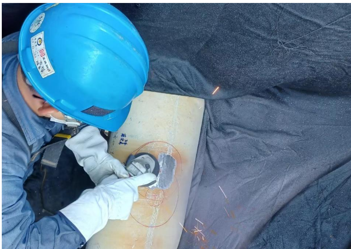
2. 管線研磨作業時防火毯鋪設情形
