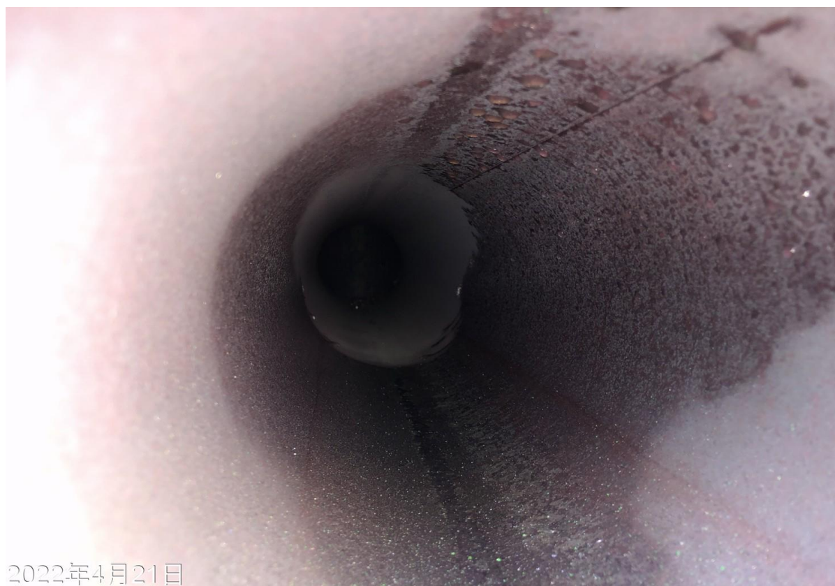
28. 管線切管後內部阻斷情形，阻斷率 99%(6")
